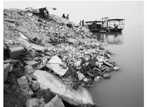
堆积如山的建筑垃圾
